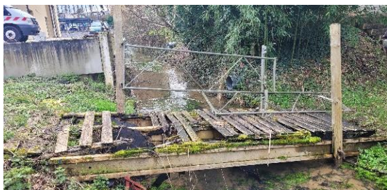
Passerelle dégradée et abandonnée
