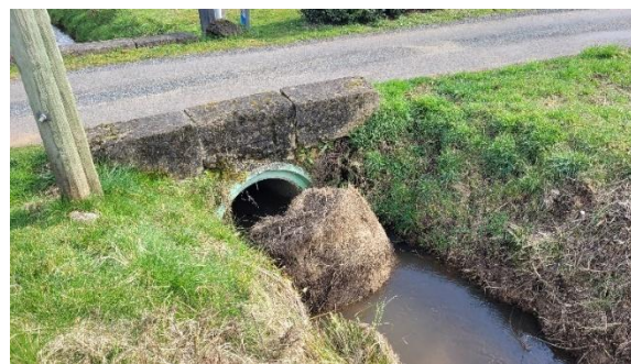
Encombrement peu habituel en entrée de buse, pourtant de bon diamètre, "La Buguette".
