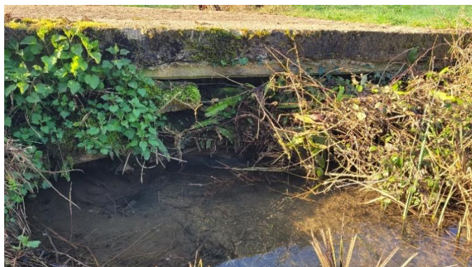
Ouvrage colmaté amont moulin du Trel
