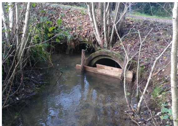
Répartition des eaux non-conforme en amont du moulin de l'Evêque. L'ouvrage de droite, barré par des planches, va vers le Pontou. Celui de gauche, en arrière-plan, alimente le bief du moulin
