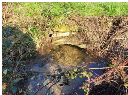
Ouvrage colmaté sur le Treuil à "La Porte"
