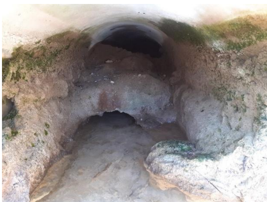
Exemple de calcification d'une buse sur le Treuil, aval moulin du Trel
