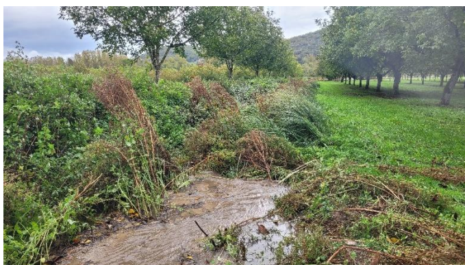
Végétation dense et colmatage dans le lit mineur – Béringot aval.
