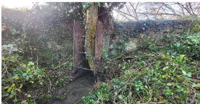
Ouvrage abandonné avant la confluence : ancien pont du chemin de halage avec grille en fer et frêne commun dans le lit mineur.
