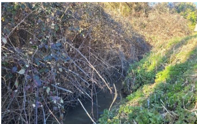
Perturbation de l'écoulement : présence d'un roncier dense et d'un grillage dans le lit mineur, aval du collège.
