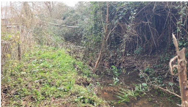
Etat d'encombrement de la Gastouze, en aval direct de la voie ferrée
