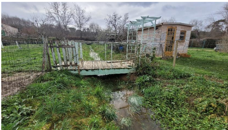
Passerelle mal positionnée, susceptible de ralentir les flux lors d'événements climatiques exceptionnels
