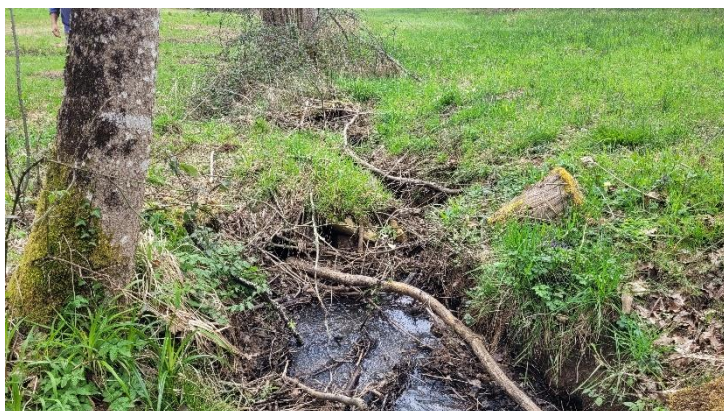
Exemple d'ouvrage abandonné, ici une buse détériorée et encombrée
