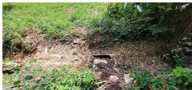
Exemple d'ouvrage (buse) défectueux dans le lit mineur en assec, amont du Raysse
