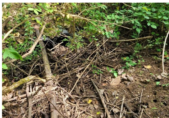
Ouvrage colmaté par un embâcle, amont du bourg du Buisson
