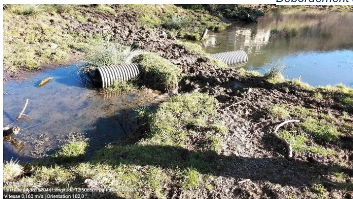
Buse servant de traversée du cours d'eau par les bovins
